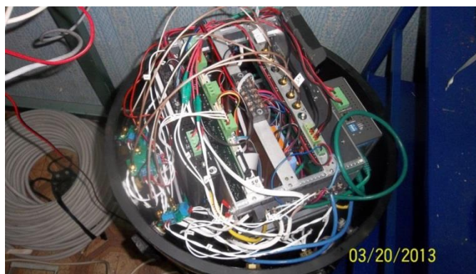
Рис. 4.3.8. Коммутационный модуль гирлянды в глубоководном корпусе.
